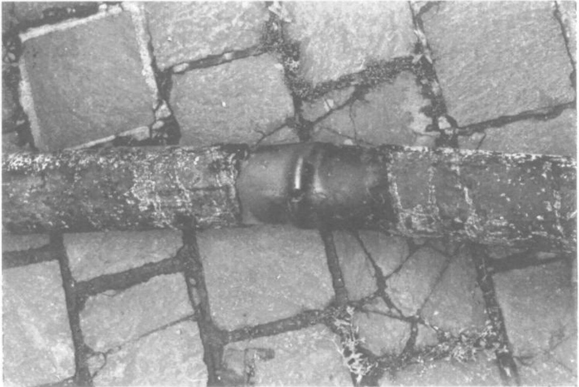
Fig. 6 - Zona di perdita.
