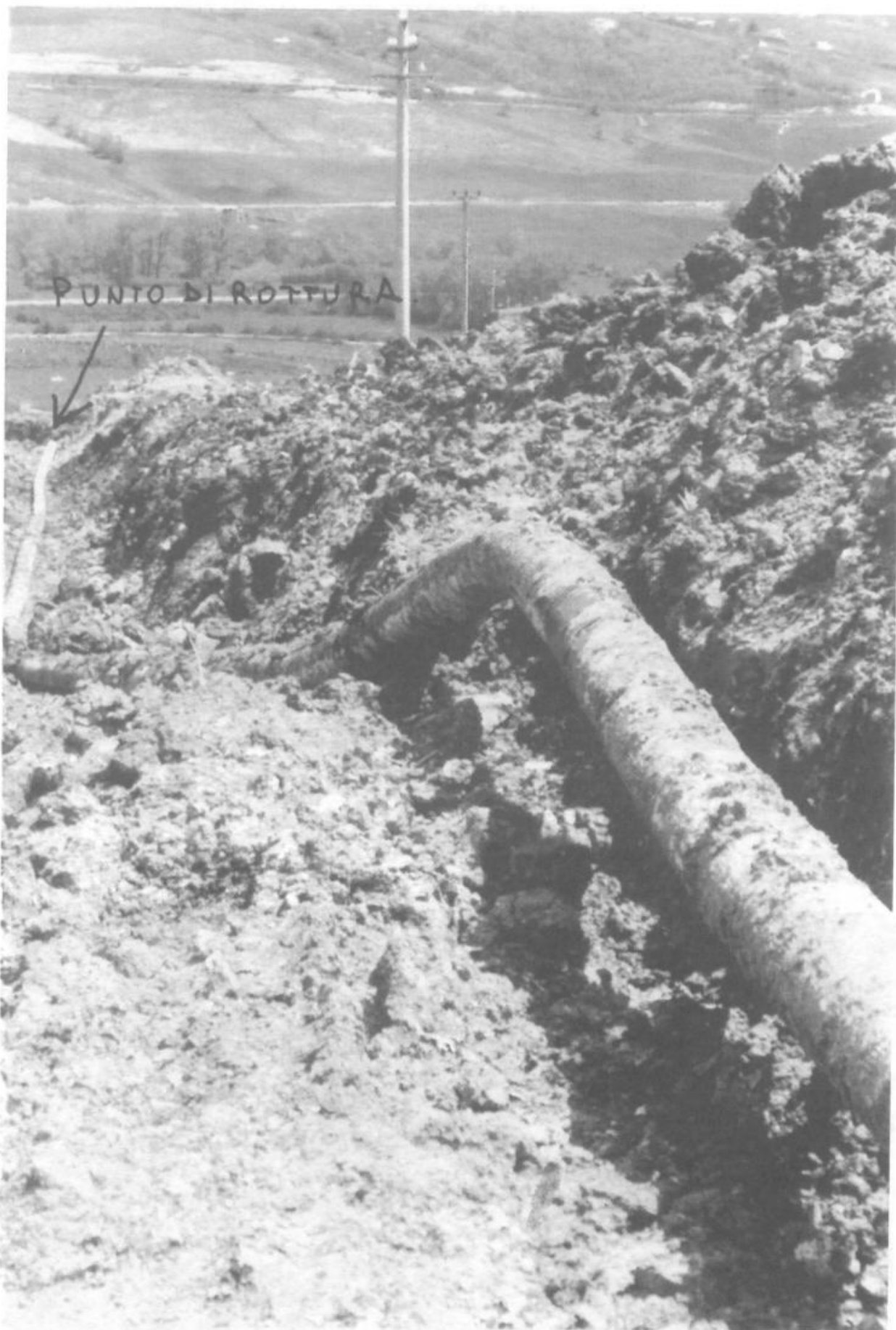
Tratto di tubo a monte del punto di rottura, instabilizzatosi a posteriori a seguito dello scavo per rilascio tensionale - È indicato più a valle il punto di rottura
