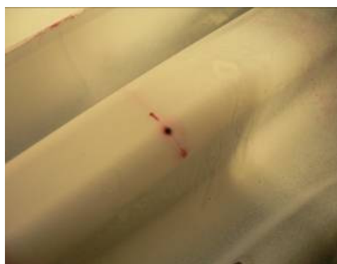
Figura 11: Cricca sottoposta a trattamento con liquidi penetranti.
