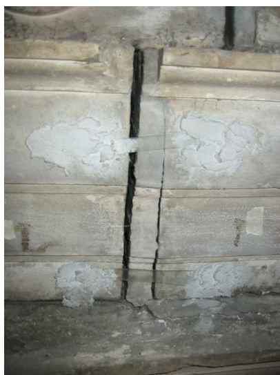
Figura 3: Sala del Tintoretto, Scuola Grand di San Rocco. Sensore SR11 installato per il monitoraggio della crepa.
