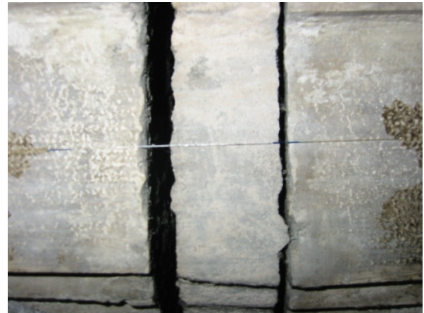
Figura 5: Sala del Tintoretto, Scuola Grand di San Rocco. Sensore SR11 installato per il monitoraggio della crepa.
