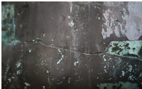
Figura 8: Particolare della cricca.
