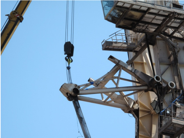
Figura 1: Zona di rottura del traliccio costituente il braccio della gru.
