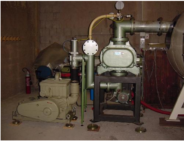
Impianto di pompaggio del SAS
